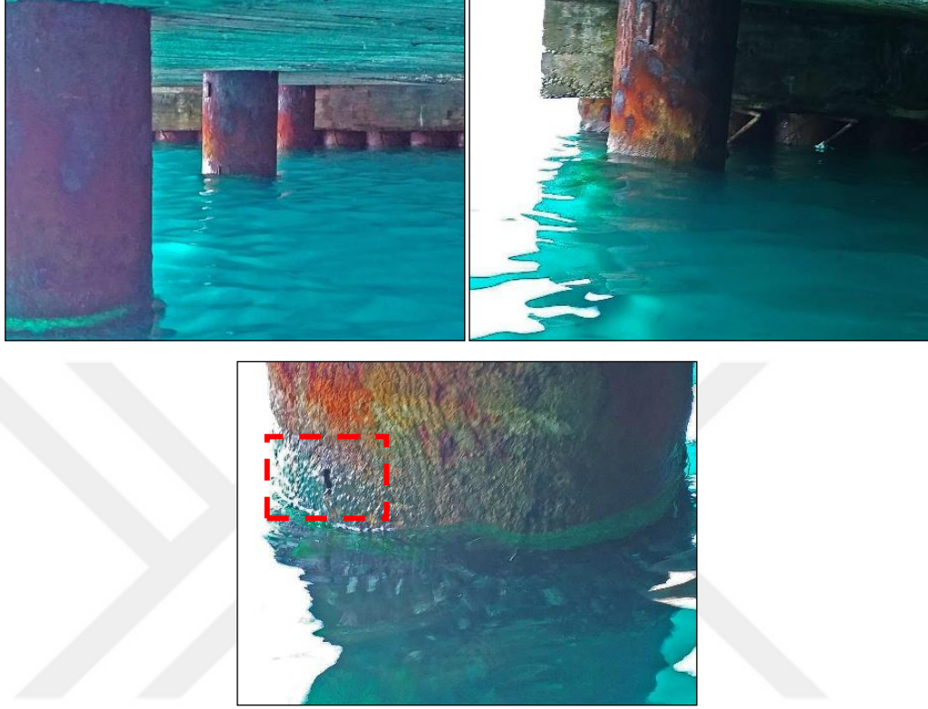
Şekil 2.6. Kolonlarda meydana gelen eliptik şekilli delik oluşumu.
