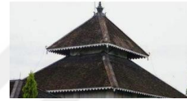
Demak Camii'nin eski shingle çatısı.
