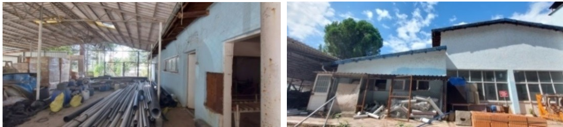
Şekil 5.66. Sırasıyla Yapının Güney ve Doğu Cephesinde Yer Alan Demir Sundurma Çatı ve Tel Kafes (Yazar Arşivi, 2023)
