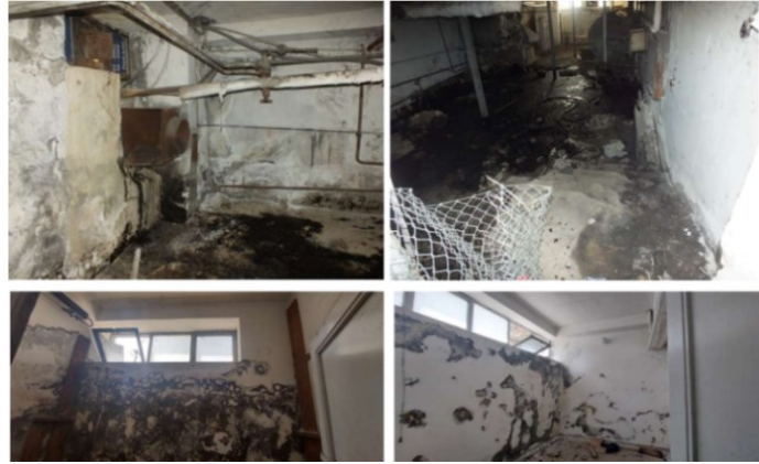
Şekil 5.63. İşletmenin Bodrum Duvarlarında Oluşan Nemlenme ve Kabarmalar (Seda Kavukçuoğlu Yüzer Arşivi; Yazar Arşivi, 2023-2024)
