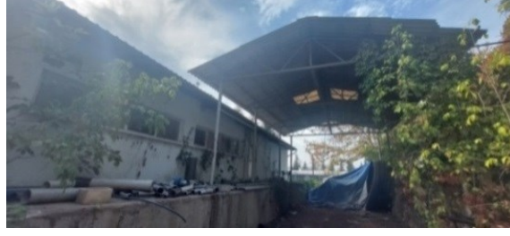
Şekil 5.67. Yapının Kuzey Cephesinde Yer Alan Demir Sundurma Çatı (Yazar Arşivi, 2024)
