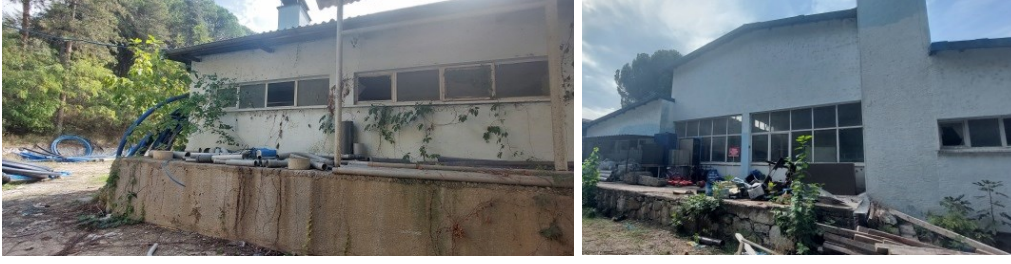
Şekil 5.71. Yapının Pencerelerinde Görülen Parça Kayıpları ve Kırılmalar (Yazar Arşivi, 2023-2024)
