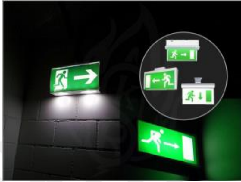
Şekil 2.8. Acil durum aydınlatma ve yönlendirme sistemleri
