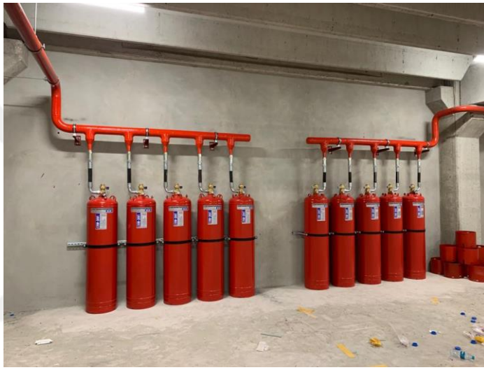
Şekil 2.15. FM200 gazlı yangın söndürme sistemleri
