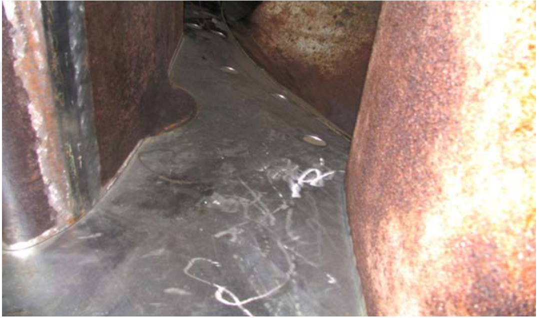
Şekil 6.2: Keban Hidroelektrik Santralında bir türbin çarkının aşınmaya uğramış bölgesi (EİE, 2010).
