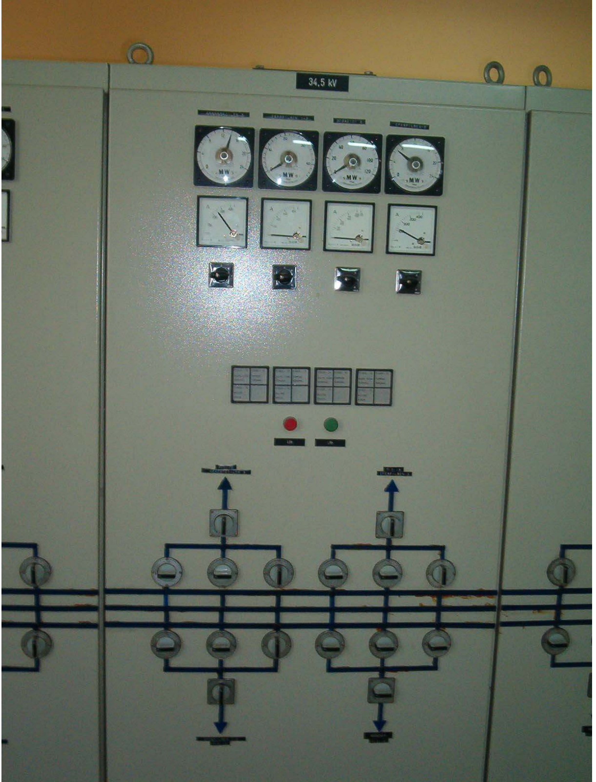
Şekil 4.5 34,5 kV kumanda panosu
