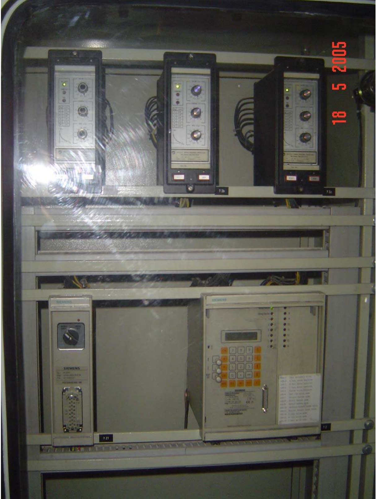
Şekil 4.7 154 kV röle panosu
