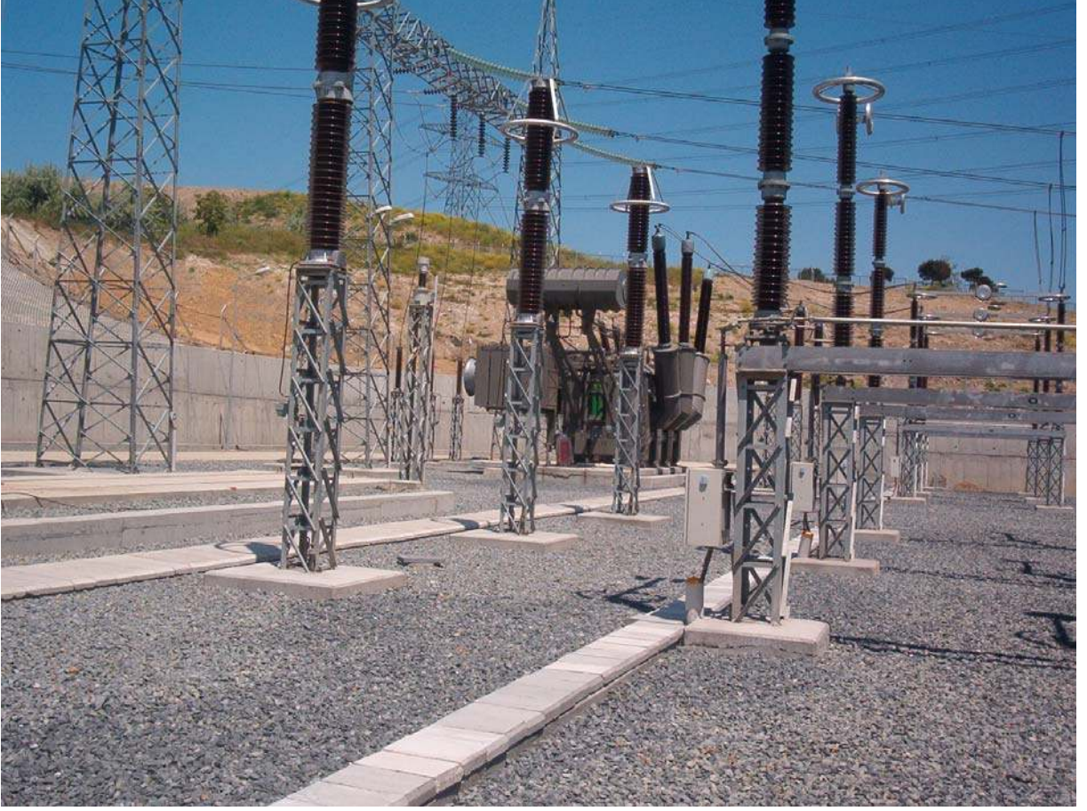
Şekil 4.2 380 kV Atışalanı açık şalt merkezi
