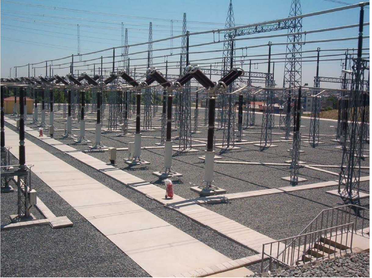
Şekil 4.3 380 kV Atışalanı açık şalt merkezi
