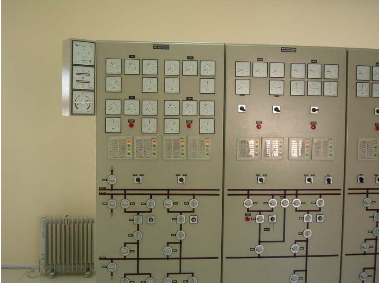
Şekil 4.4 380 kV kumanda panosu
