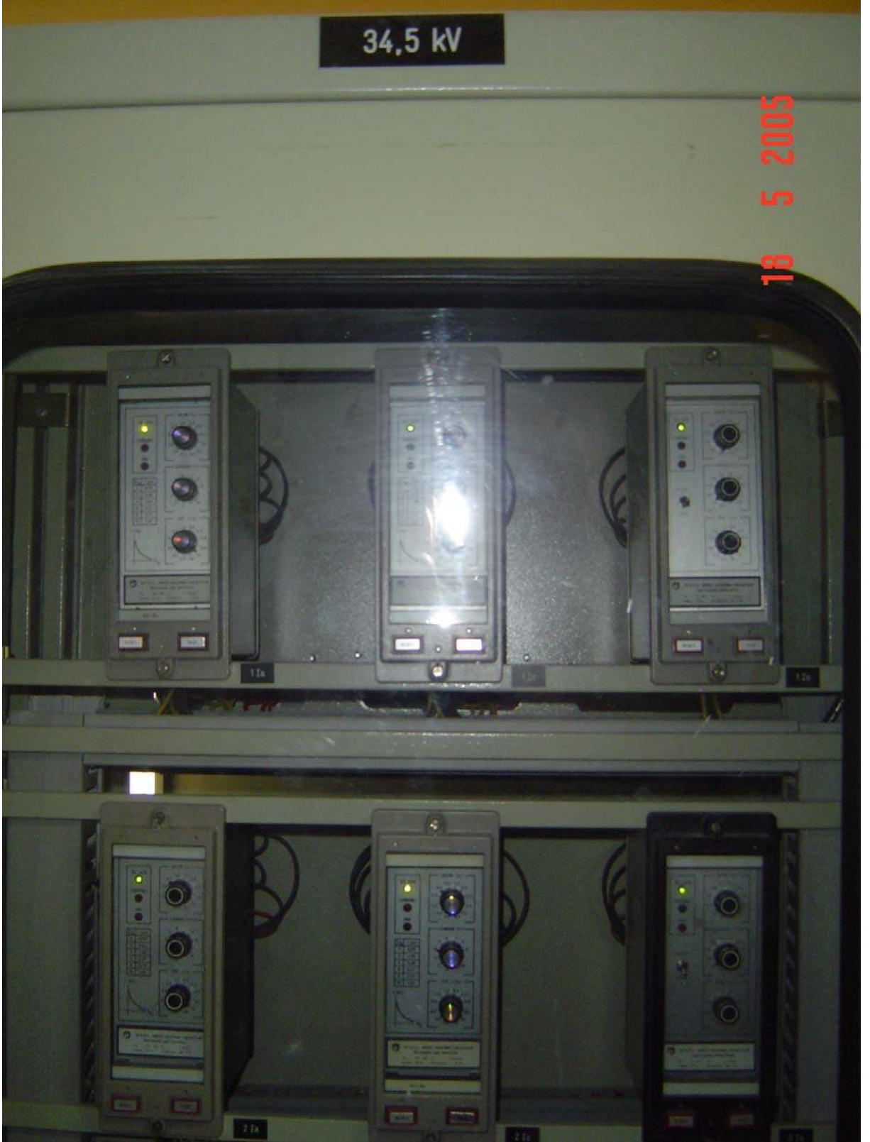
Şekil 4.8 34,5 kV röle panosu
