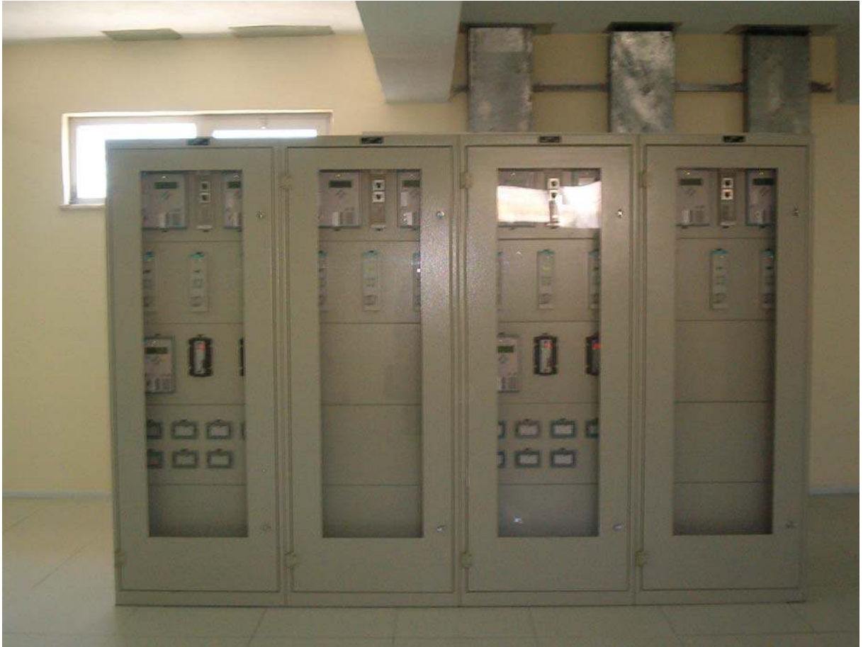
Şekil 4.6 380 kV röle panosu
