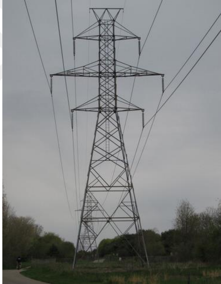
Şekil 3.6. Çok yüksek gerilim kulesi
