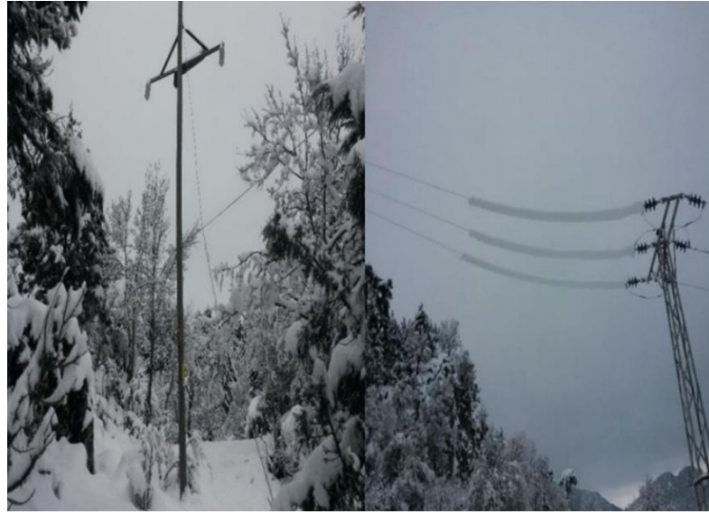
Şekil 3.13. Fırtına ve kar nedeniyle hat kopması (Doğanay, 2022).
