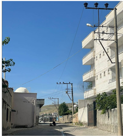
Şekil 3.5. OG iletken kopuğu
