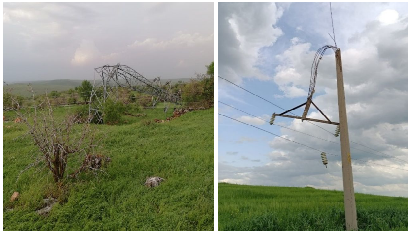
Şekil 3.11. Rüzgâr nedeniyle oluşan arızalar
