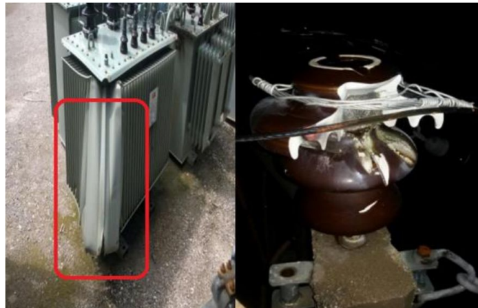
Şekil 3.12. Şarjlı havalarda yıldırım kaynaklı oluşan arızalar (Doğanay, 2022).
