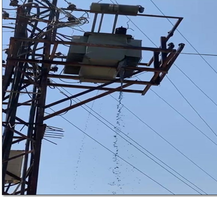
Şekil 3.1. Trafo Yanmasından Dolayı Yağ Deposunun Delinmesi
