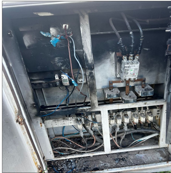
Şekil 3.10. dağıtım panosu aydınlatma kontaktör yanması
