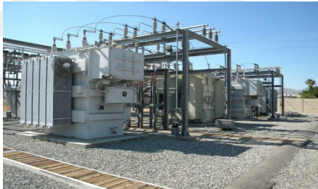
Şekil 4.1. Paralel bağlı transformatörler (Elektrikport, 2018).
