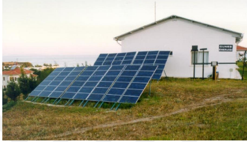
Şekil 20: Didim PV Sistem Örneđi
