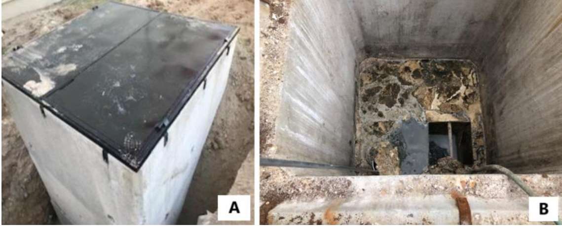
Şekil 3. 3. Yağ ayırma havuzu; A: Havuz dış görünüm, B: Havuz iç görünüm
