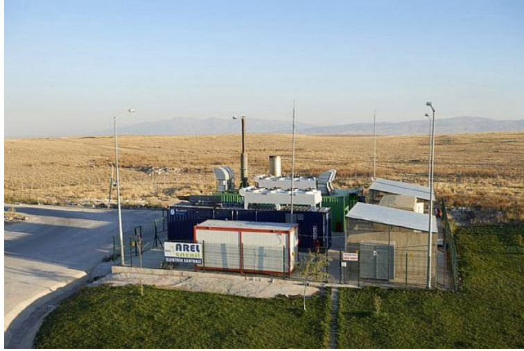
Şekil 3.16. Elektrik üretim tesisi genel görünümü.
