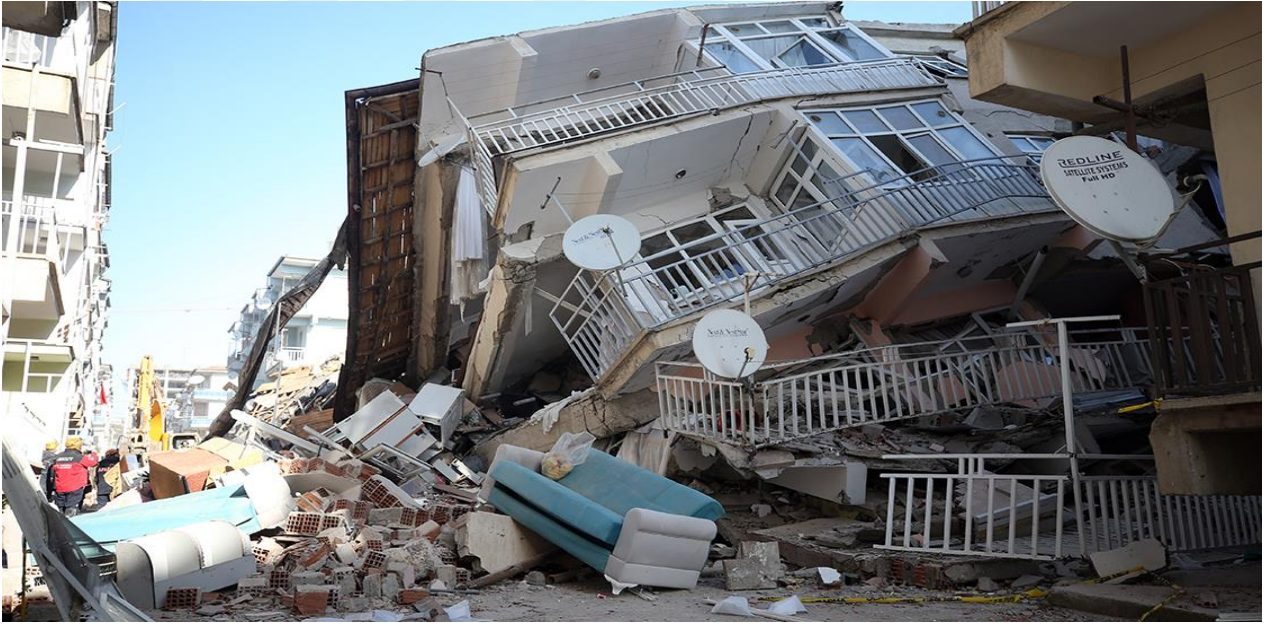
Şekil 1.3. Elazığ depremi sonrası yıkılan bina
