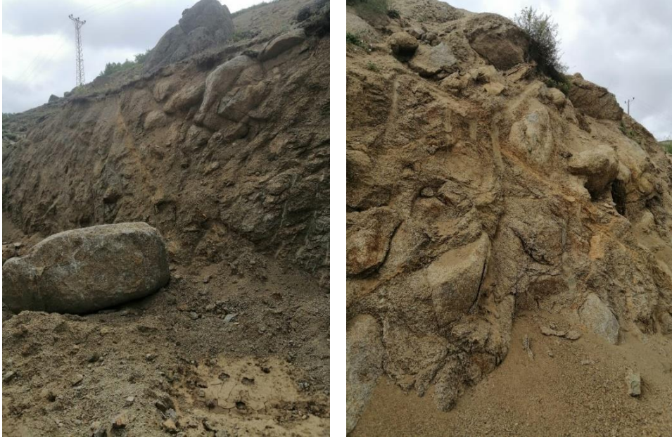
Şekil 6. Kazıkbeli Plütonu'na ait kayalarda gözlenen arenalaşma
