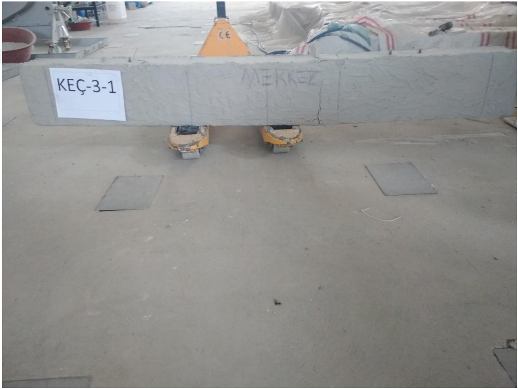
Şekil.4. 24.KEÇ3-1 Kirişi Üzerinde Görülen Kırılma-Çatlak Fotoğrafı
