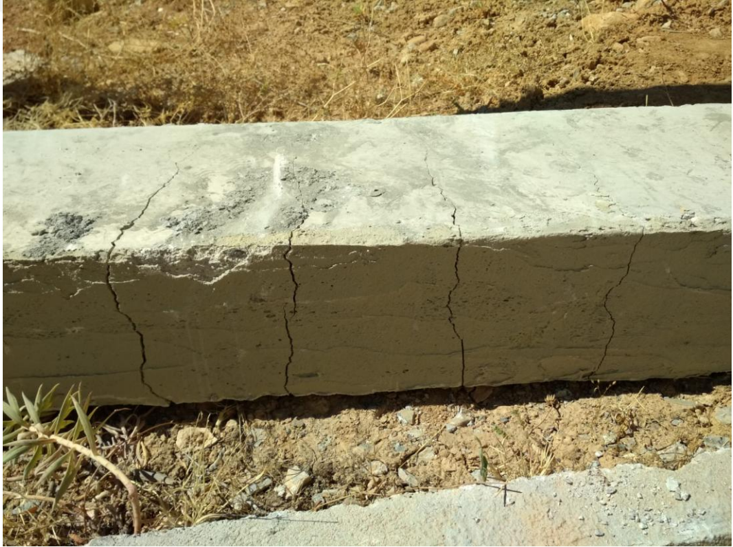
Şekil.4. 13.KE-1 ,KE-2 Kirişleri Üzerinde Görülen Kırılma-Çatlak Fotoğrafi
