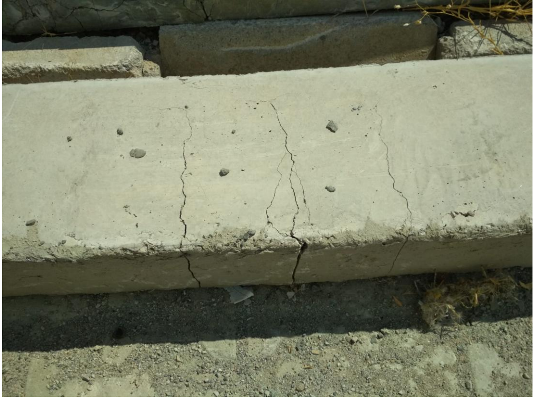
Şekil.4. 8.KY-1 ,KY-2 Kirişleri Üzerinde Görülen Kırılma-Çatlak Fotoğrafi
