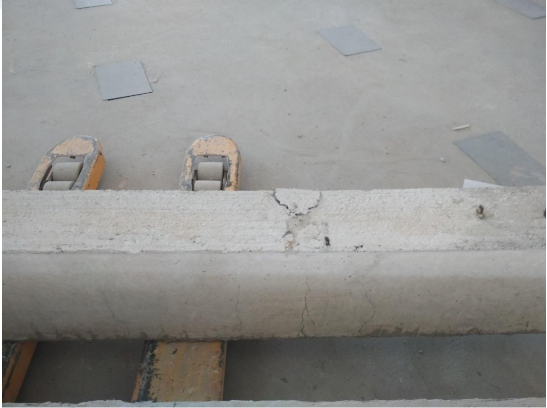
Şekil.4. 17.KEE-1 ,KEE-2 Kirişleri Üzerinde Görülen Kırılma-Çatlak Fotoğrafi
