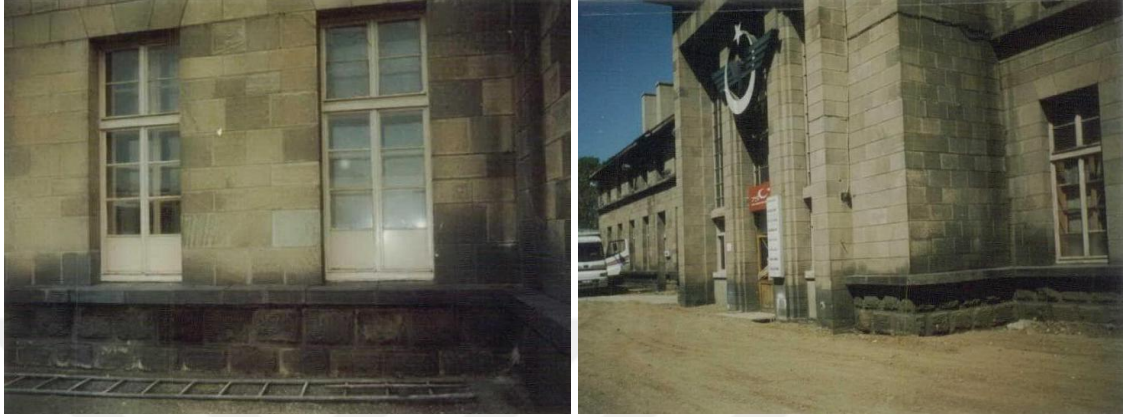
Resim 57. Erzurum Gar Binası cephede oluşan kararmalardan genel görünümü (EKVKBK Arşivi)
