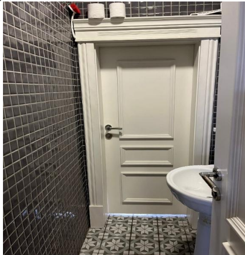
Resim 133. Erzurum Gar Binası dođu kanadı birinci kat ıslak mek n genel g r n m  ( lknur Keleř)
