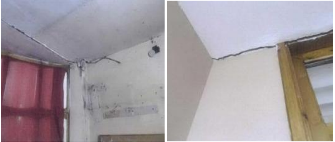
Resim 41. Erzurum Gar Binası büfe ve kuaför bölümlerinde oluşan çökme ve çatlaklıklardan genel görünümü (EKVKBK Arşivi)
