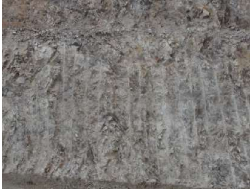
Şekil 3.17 Basamak şevinde patlatma sonrası görülen önkesme izleri.
