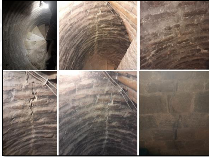
řekil 4.27. Ulu Camii minaresinde gzlemlenen atlaklar
