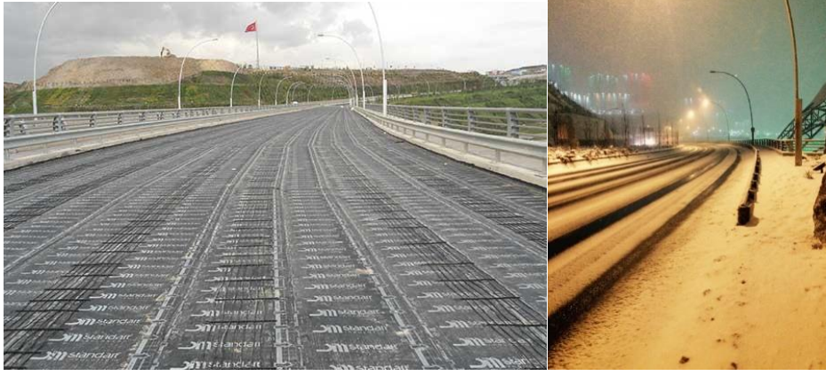
Görsel 18: Kuzey Ankara Çevre Yolunda Uygulanan İletken Isıtma Kablo Sistemi
