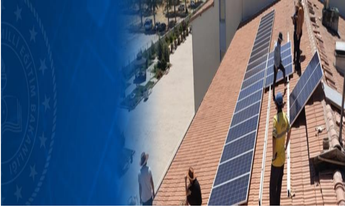
Ek – 15 Malatya'daki okullarda güneş enerjisiyle elektrik üretimi (MEB, 2022)
