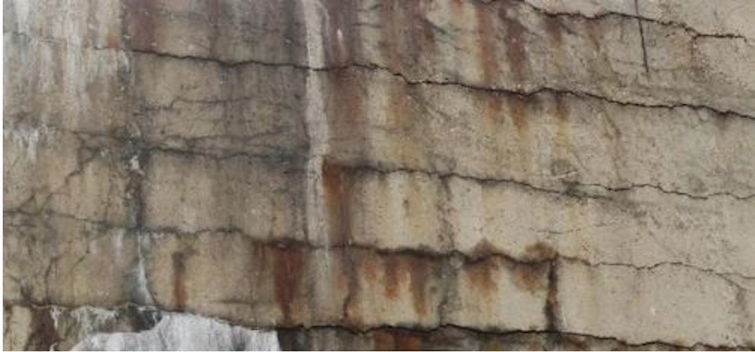
Şekil 1.3: Köprünün temelindeki yüzeyde leke ve çatlaklar
