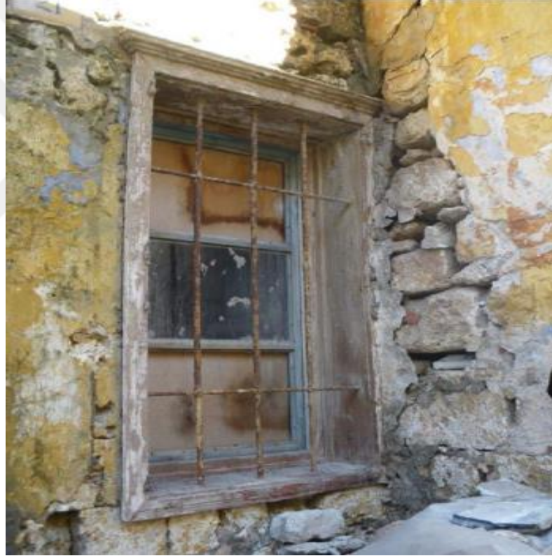
Şekil 1.5:. Rodos Ortaçağ Kasabası örneğinden pencerelerin yanındaki taş duvarın bozulması .
