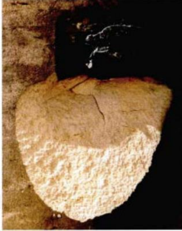
Şekil 1.1: Kompakt malzeme kaybına yol açan mekanik hasar nedeniyle çürüme.
