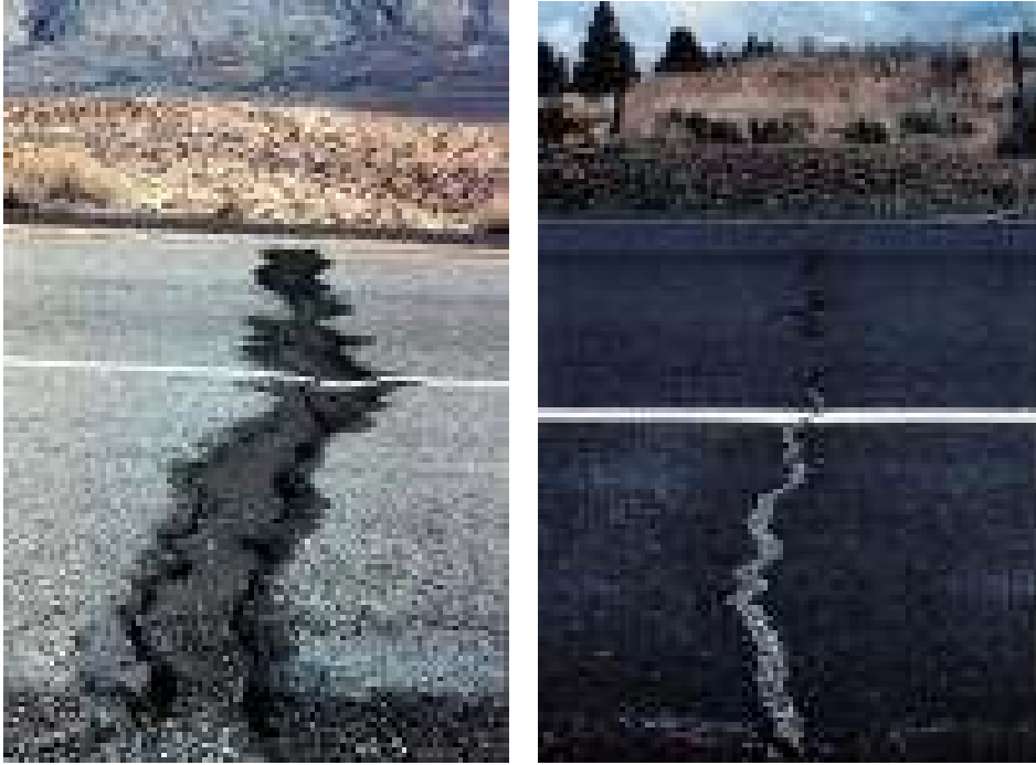
Resim 4.2. Esnek üstyapılarda düşük sıcaklıklarda oluşan çatlamlar
