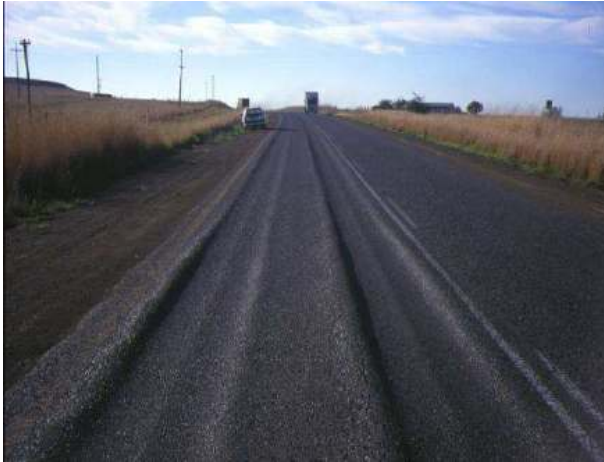
Resim 4.1. Esnek üstyapıda oluşan tekerlek izi bozulması
