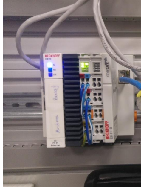
Şekil 3.6. PLC Yapılandırma moduna geçilmesi
