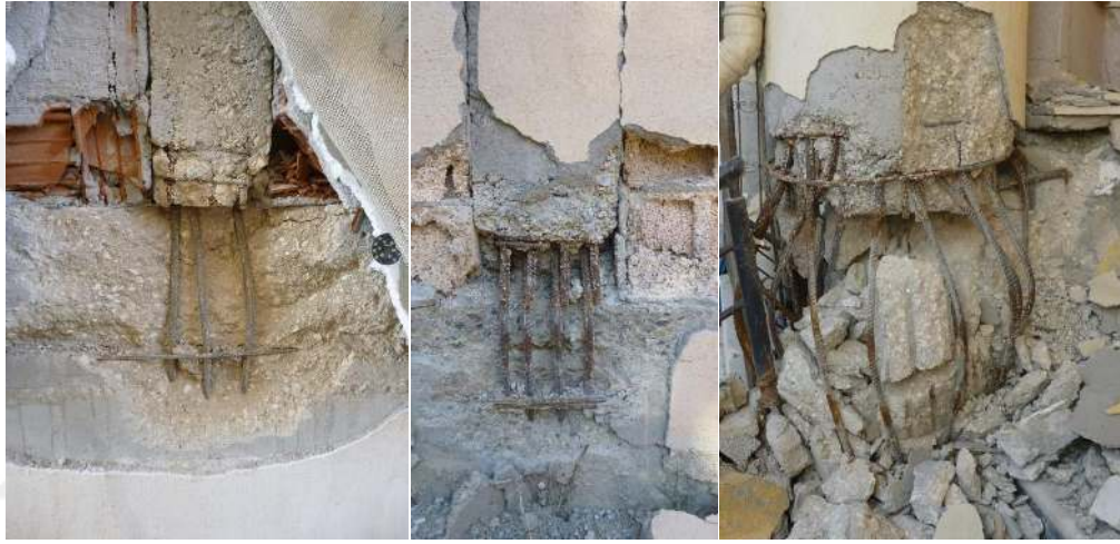
Görsel 2.1. Birleşim bölgesindeki enine donatı yetersizliği kaynaklı hasarlar (Avşar vd, 2023)
