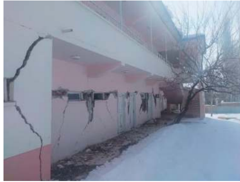
(e) Kısa kolon kaynaklı hasar
