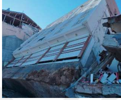
(a) Zemin sıvılaşması kaynaklı hasar
