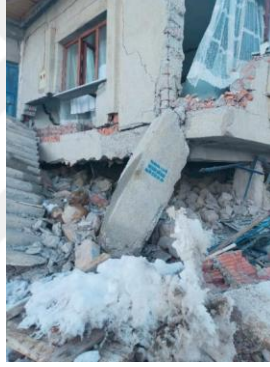
(c) Güçlü giriş-zayıf kolon kaynaklı hasar
