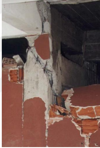
(g) Kısa kolon davranışı kaynaklı hasar (Saatçioğlu vd., 2001)
