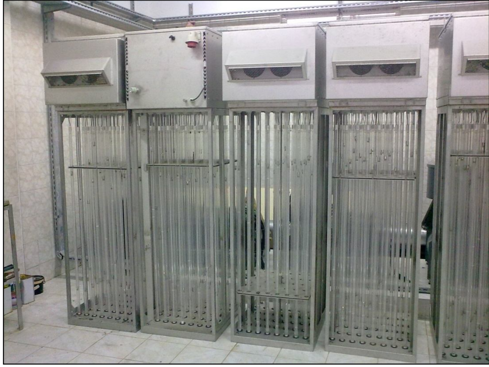
Şekil 4.3 Ultraviyole ünitesi (Alanya Oba atıksu arıtma tesisi 2009)
