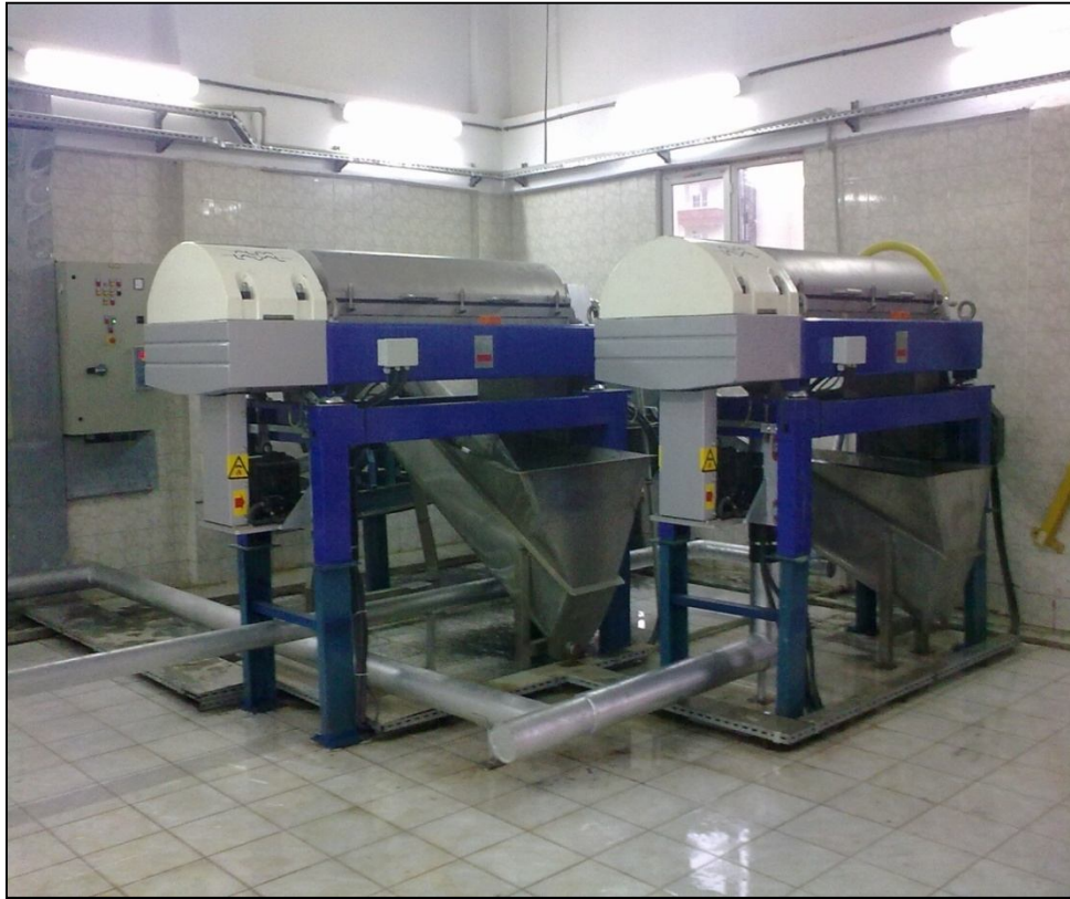
Şekil 4.4 Dekantörler (Alanya Oba atıksu arıtma tesisi 2009)
