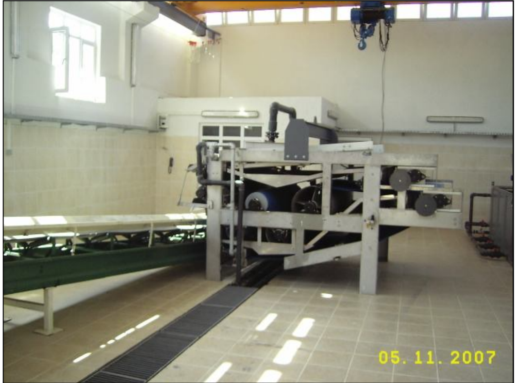
Şekil 3.7’de Mahmutlar atıksu arıtma tesisinde belt filtre pres ünitesi
