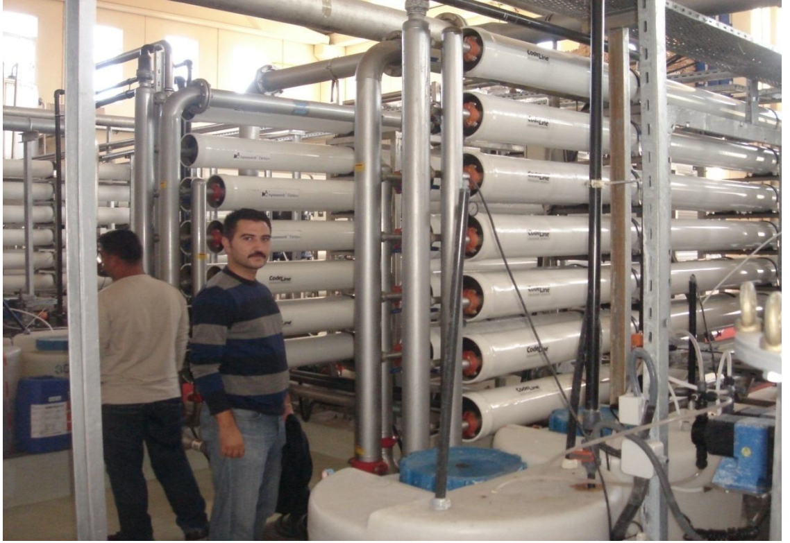
Şekil 2.9 Ultrafiltrasyon ve ters osmoz sistemleri (Konya Organize Sanayi İçmesuyu Arıtma Tesisi)
