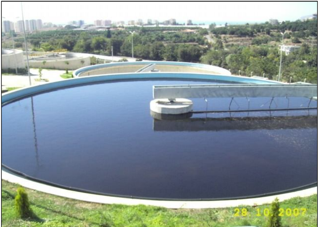
Şekil 3.6 Mahmutlar atıksu arıtma tesisinde çökeltme havuzu
