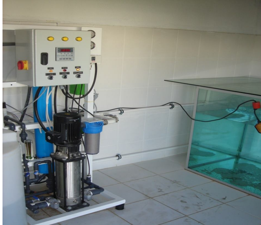
Şekil 2.8 Ters osmoz ünitesi (Bodrum Konacık Evsel Atıksu Arıtma Tesisi)
