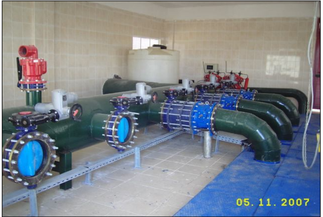
Şekil 3.2 Mahmutlar atıksu arıtma tesisi ana terfi merkezi
