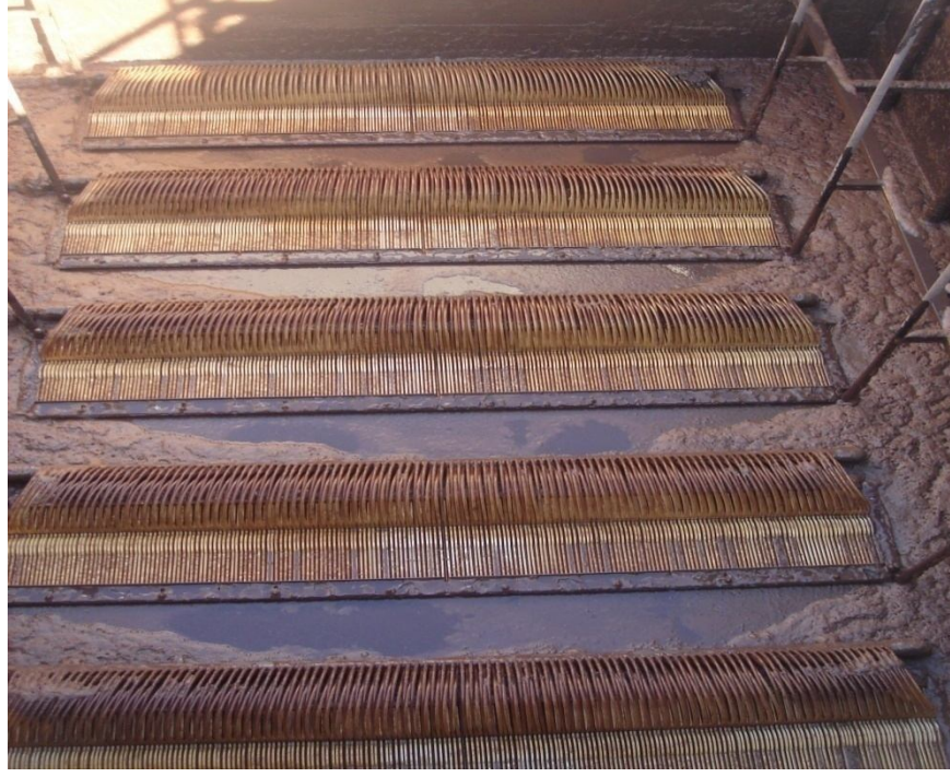
Şekil 2.7 Batık membran reaktör ( İzmir Torbalı Organize Sanayi Biyolojik Atıksu Arıtma Tesisi)
