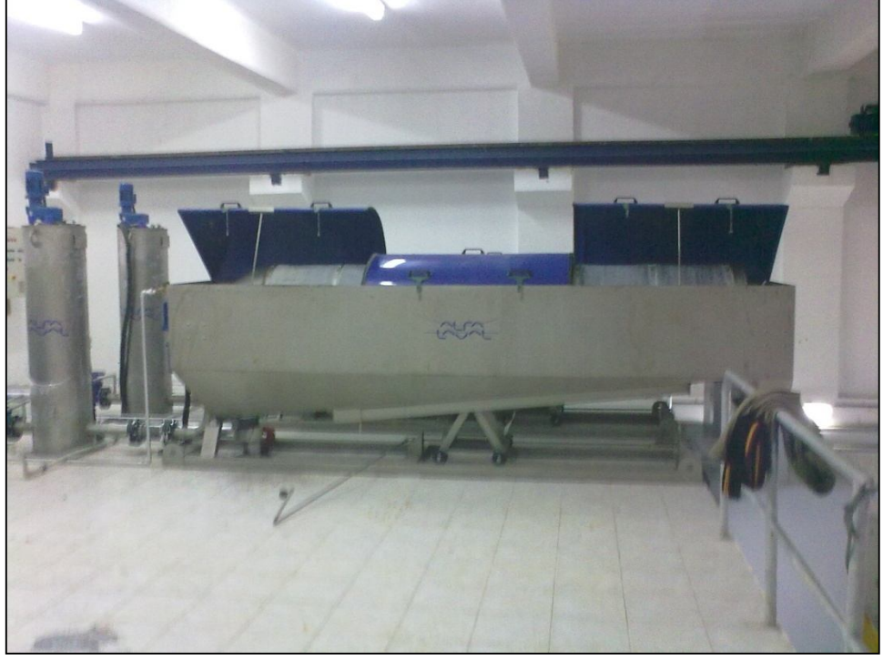
Şekil 4.1 Kıvamlaştırıcı (Alanya Oba atıksu arıtma tesisi 2009)
