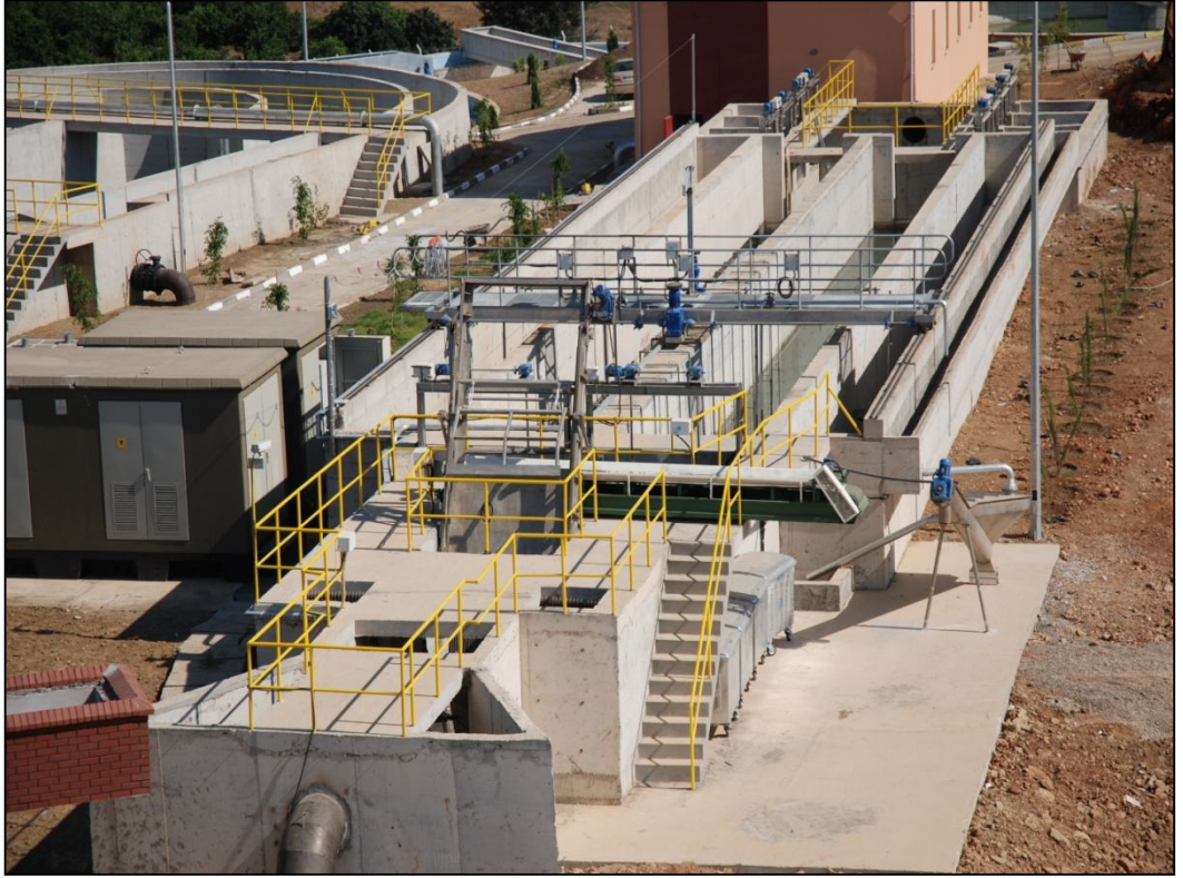
Şekil 3.3 Mahmutlar atıksu arıtma tesisi fiziksel arıtma üniteleri
