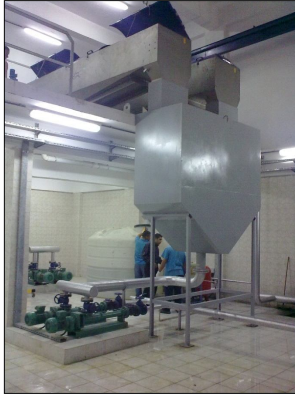
Şekil 4.2 Buffer Tankı (Alanya Oba atıksu arıtma tesisi 2009)
