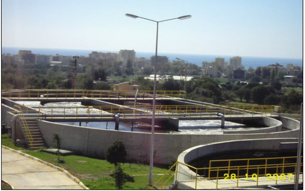
Şekil 3.5 Mahmutlar atıksu arıtma tesisinde havalandırma havuzu
