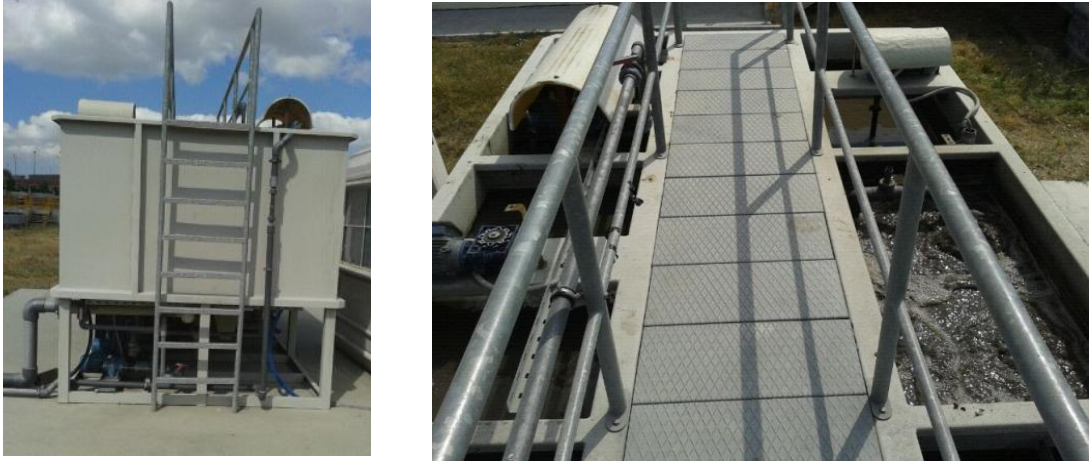
Şekil 6.1 Çalışmada kullanılan pilot tesisin yandan ve üstten görünümü.
