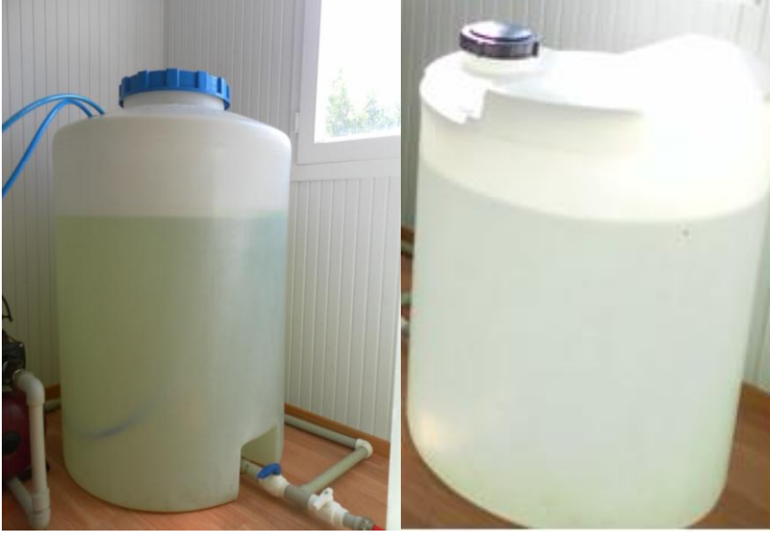
Şekil 2.13 Arıtılmış atıksu depolama tankı şekil 2.14 Arıtılmış su deposu
