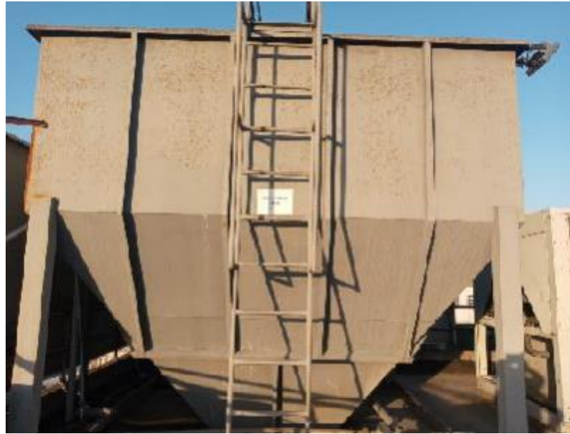
Görsel 4.5. Çamur yoğunlaştırma havuzu
