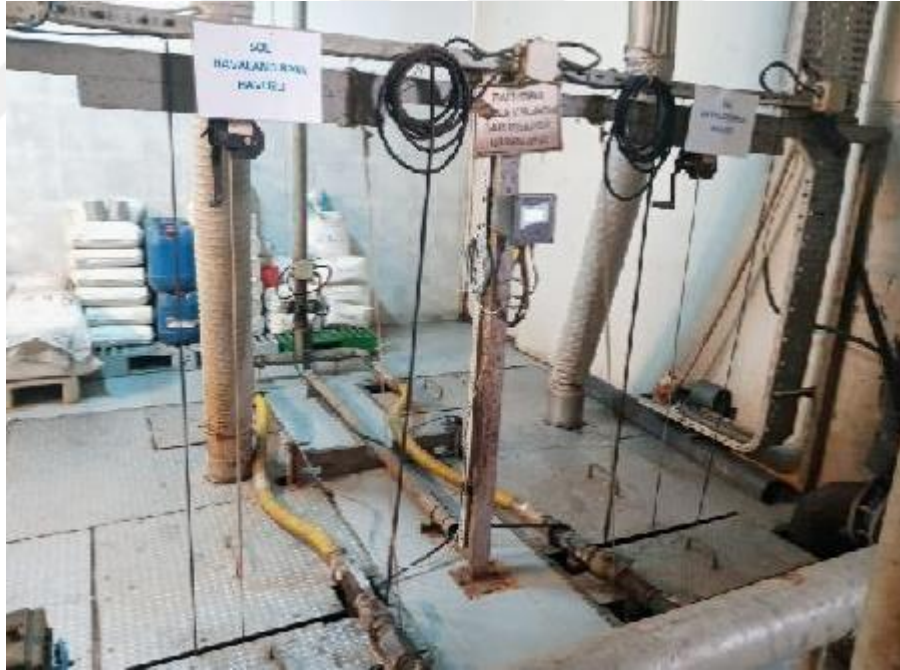
Görsel 4.4. Havalandırma tankları
