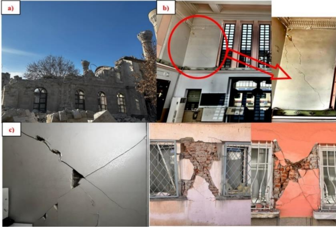
Resim 1.1. Kahramanmaraş depremleri sonrası yığma yapı hasarlarından bazıları
