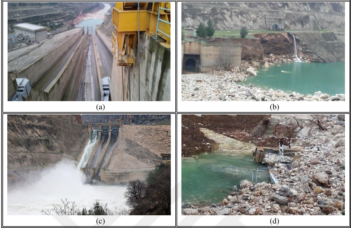
Şekil 2.15. Dicle Barajında 2018 yılında serbest düşüden kaynaklanan hasarlar: (a) Mansapta sol yamaçta ve dere yatağında oyulma, (b) Mansap tarafında sağ sahilde oyulma, (c) Kapak koştuktan sonra dolusavaktan görünüm (d) Kopan kapakın parçası
