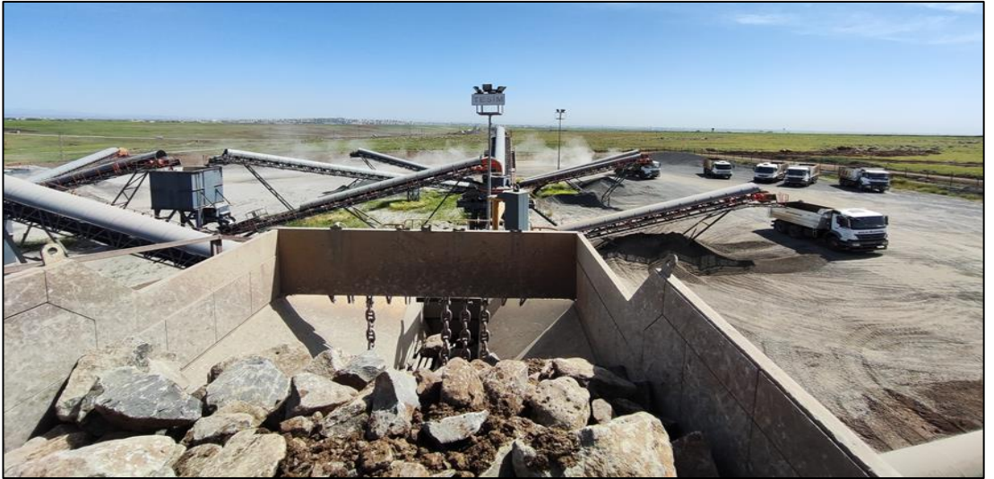
Şekil 3.5 Bazalt agrega tesisleri bunker ve bantların görünümü
