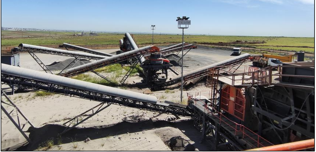
Şekil 3.6 Bazalt agrega tesisleri ve titreşimli elekler
