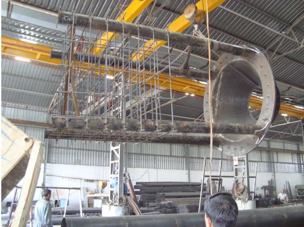
Şekil 3.17 Güneş bacası sistemi için hazırlanan taşıyıcı ünite
