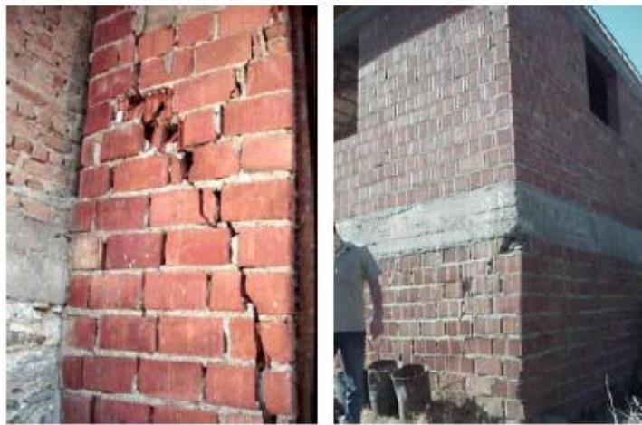
Şekil 3.2. Yığma yapılarda oluşan duvar hasarları (Çırak 2011)
