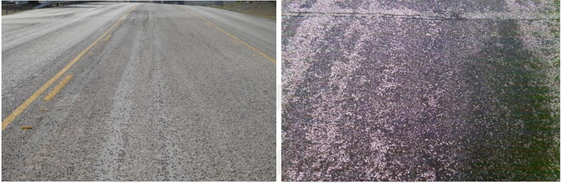
Şekil 2.6: Soyulma (agrega kaybı) sergileyen sathi kaplama yüzeyi
