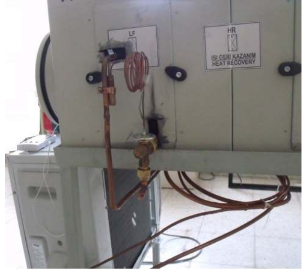
Şekil 7.3.b. Soğutma grubu yan görünüş.
