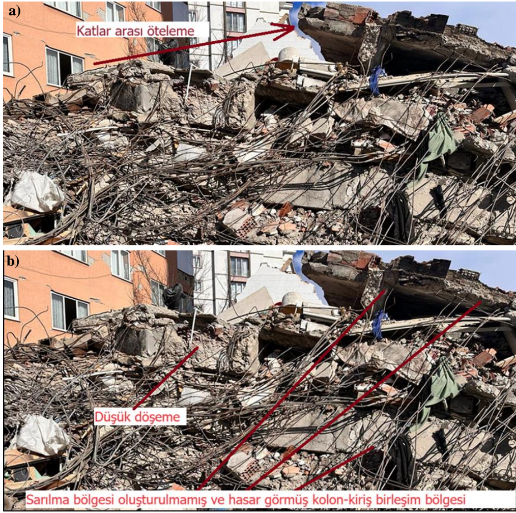
Şekil 5. 2023 Kahramanmaraş depremlerinde meydana gelen hasarlara örnekler: a) Katlar arası öteleme ve b) Sarılma bölgesi oluşturulmamış kolon-kiriş birleşim bölgesi hasarı (Cakir vd., 2024).
