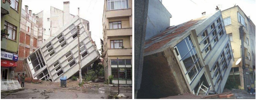
Şekil 1. 1999 Kocaeli depreminde Adapazarı'nda zayıf zemin nedeniyle yan yatmış bina (Manav vd., 2019).
