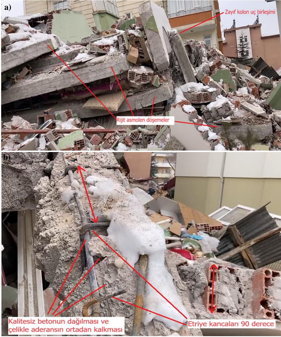
Şekil 3. 2023 Kahramanmaraş depremlerinde meydana gelen hasarlara örnekler: a) Rijit asmolon döşeme ve zayıf kolon bağlantısı ve b) Kalitesiz beton ve kötü işçilik nedeniyle dağılan betonarme kiriş (Cakir vd., 2024).
