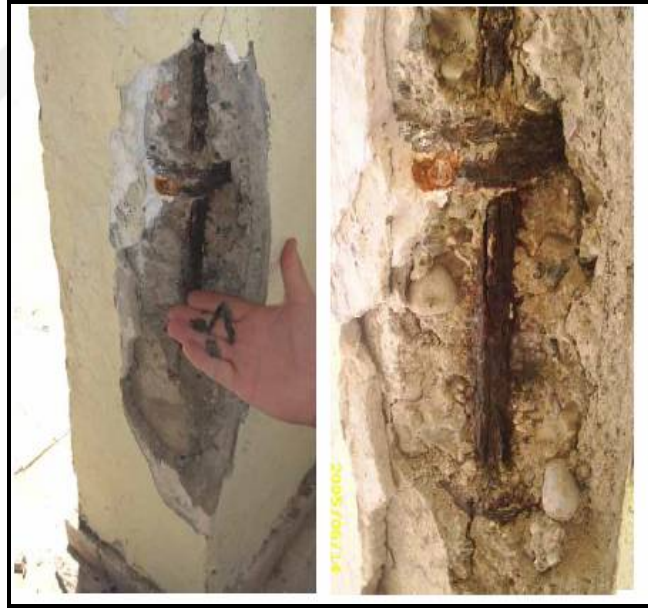
Resim 2.2 Donatının korozyon sebebiyle ufalanması (Kaplan vd. 2005).
