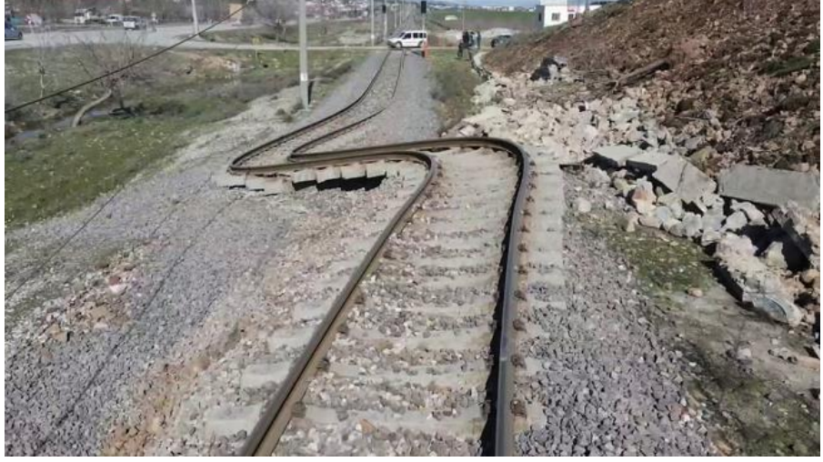
Görsel 15.1. Deprem hasarı almış demiryolu (AFAD 2023)
