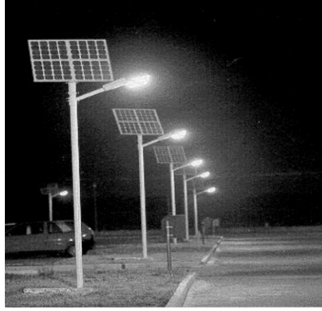
Şekil 2. 5. Güneş pilleri ile sokak aydınlatması [7]
