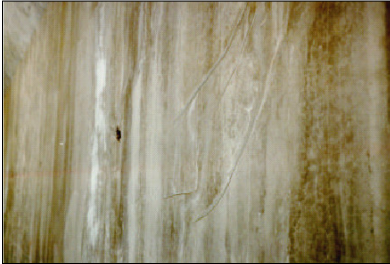
Resim 2.3. Gevşek montajdan kaynaklanan astar katlanmasının beton yüzeyine yansıması
