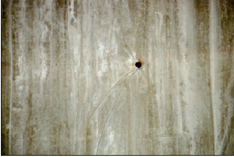
Resim 2.4. Kalıp gergi deliği boşluğu etrafında gevşek astar katlanmasının beton yüzeyine yansması
