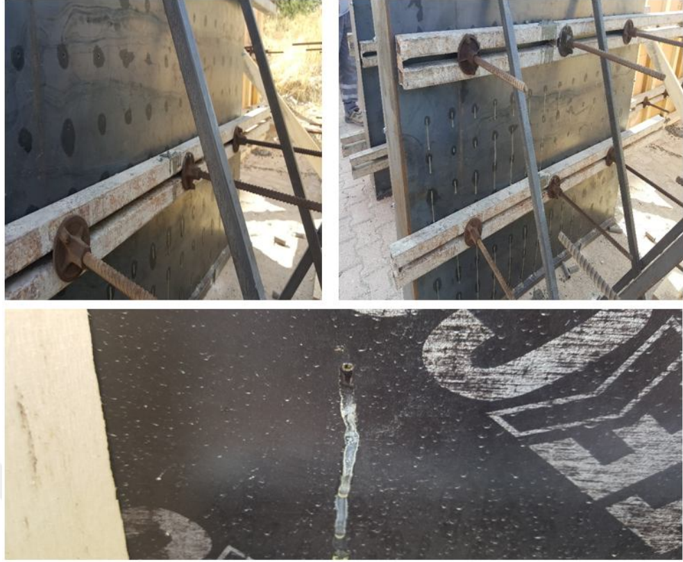
Şekil 3.28. Drenaj deliklerinden beton suyu sızma görüntüleri
