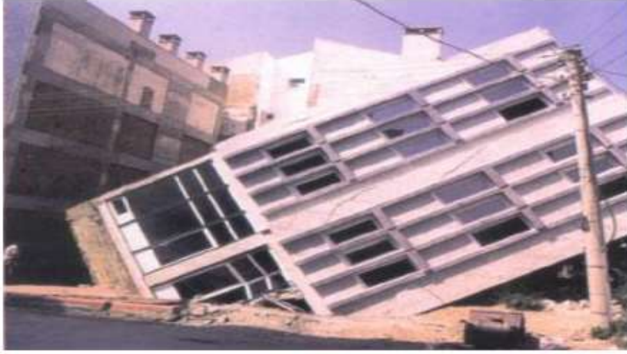
Şekil 3.5. Adapazarı depremi zemin sıvılaşması bina göçmesi (Akgün,2012)
