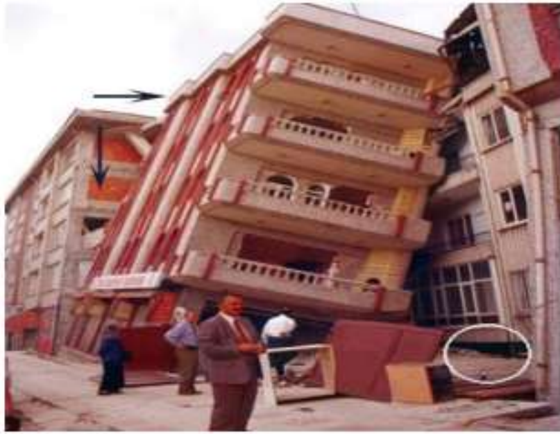
Şekil 3.6. Adapazarı depremi sıvılaşma ile yapı oturması (Akgün,2012)
