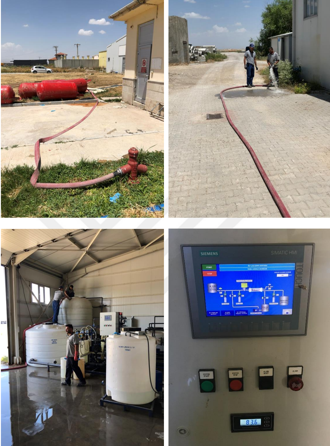
Şekil 3.8. Konya AAT'nin arıtılmış atıksularının dalgıç pompa ile pilot ölçekli membran tesisin besleme tankına iletilmesi ve tesisin PLC ekranı
