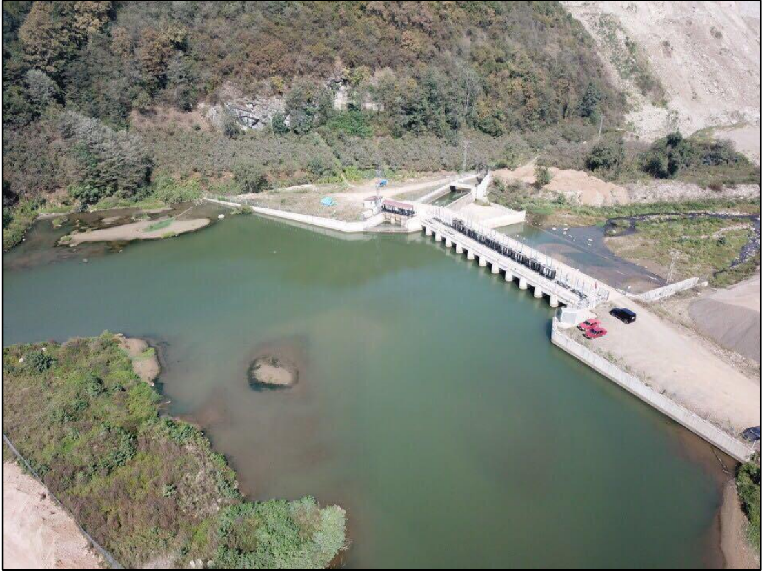
Fotoğraf 16: Elekçi Deresi Üzerinde Yer Alan Piro Hidroelektrik Santrali
