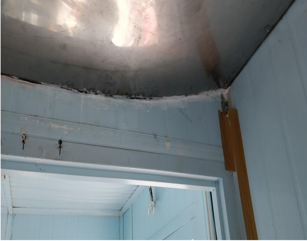
Şekil 2.23. Isı enerjisi deposu haznesinin kapatılmış hali
