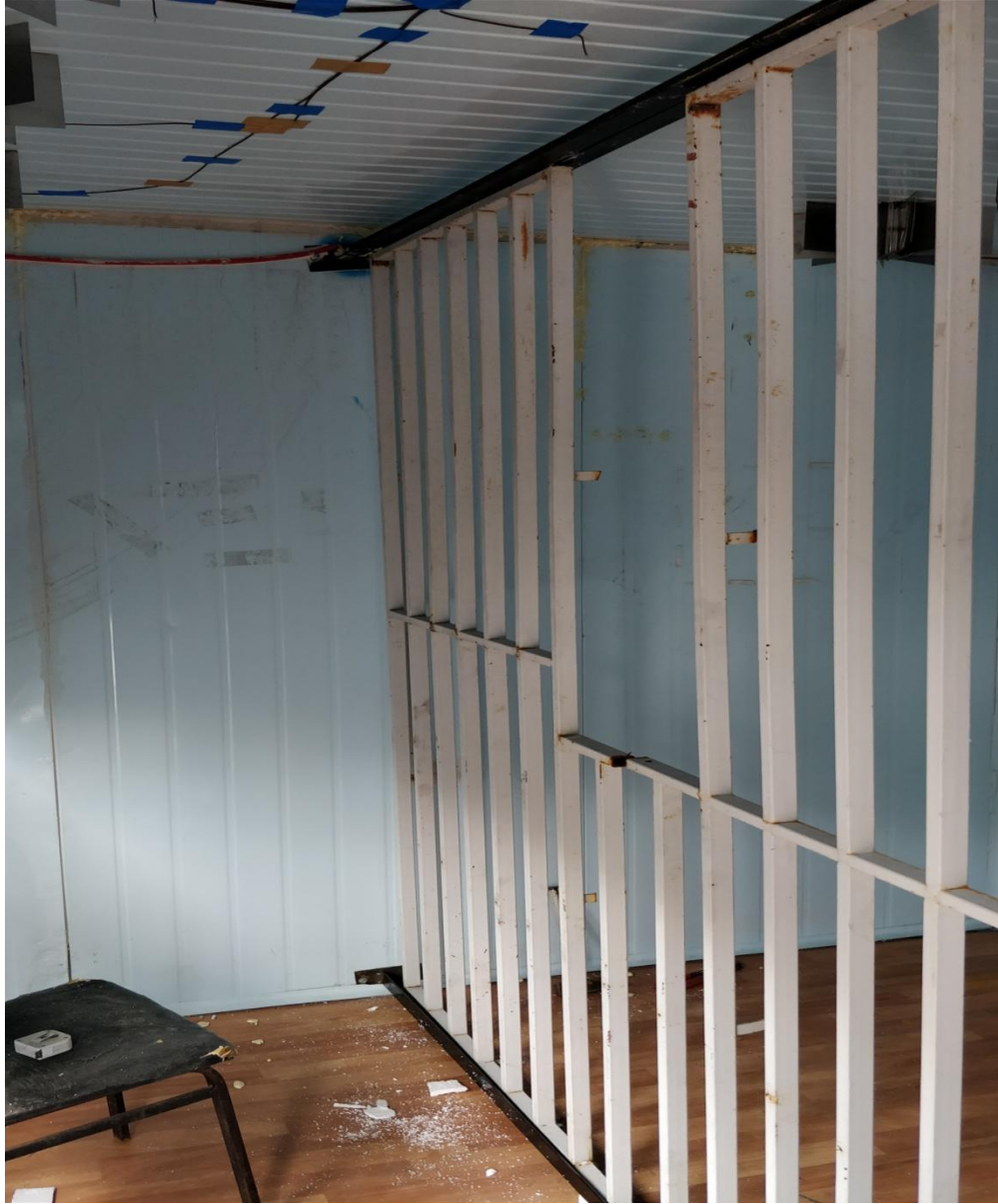
Şekil 2.4. Ölçüm odasının bölünmesinde kullanılan metal alaşımlı iskeletin görünümü
