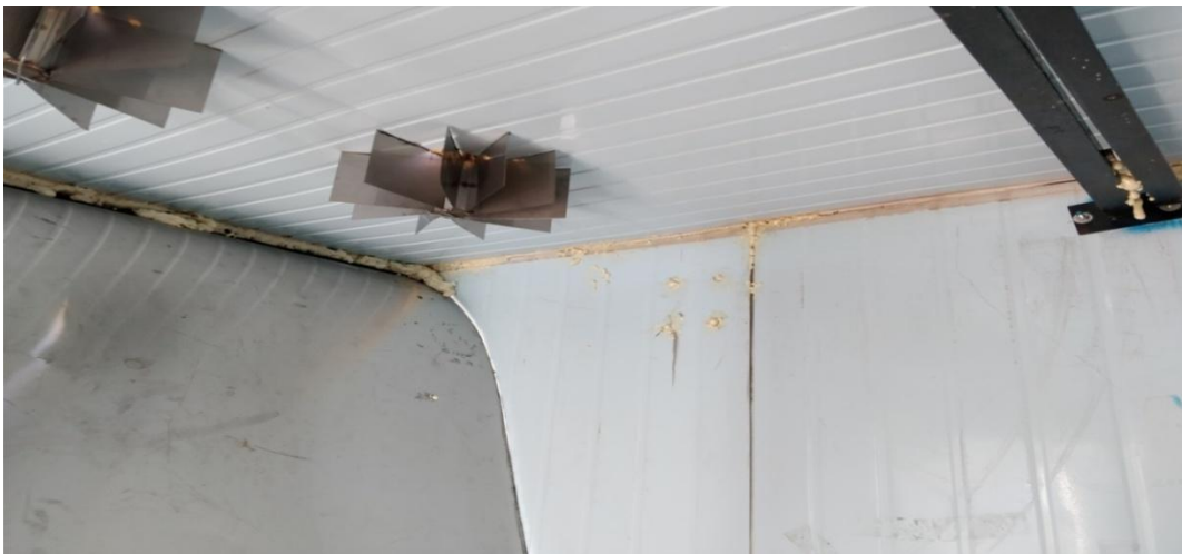
Şekil 2.13. Isı enerji deposunun iç yapısının yalıtım yapılmış hali
