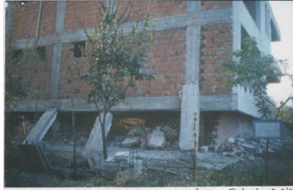
Şekil 3.11. Gölcük-Körfez Yukarı Mahalle’de zayıf kat hasarı(17 Ağustos 1999 Kocaeli Depremi, M = 7.4 )
