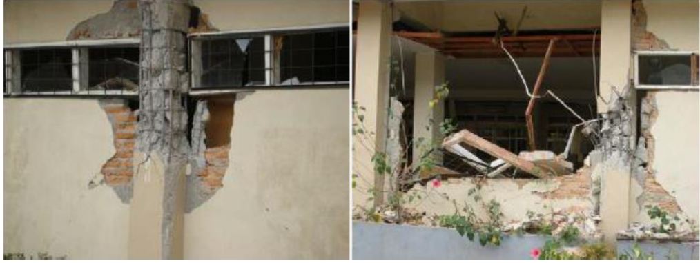
Şekil 3.15. Kısa kolon etkisi, nedeniyle bina hasarları, 2009 Padang, Endonezya depremi (Semnani, 2014).
