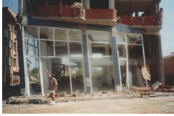
Şekil 3.13. 1999 Kocaeli depreminde Adapazarı'nda bir binada oluşan zayıf kat hasarından bir görünüm (Tezcan, 2003).
