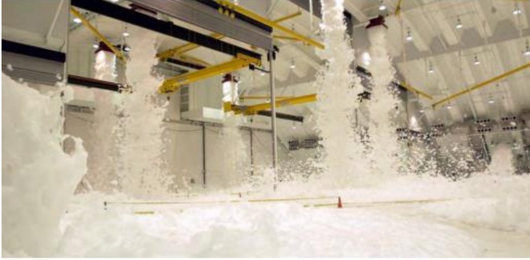
Resim 4.6. Köpüklü yangın söndürme tesisatı (Yıldız, 2021)
