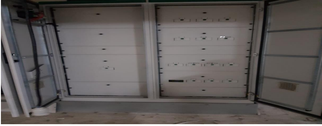
Resim 7.3.Elektrik panosunda izolasyonun olmaması
