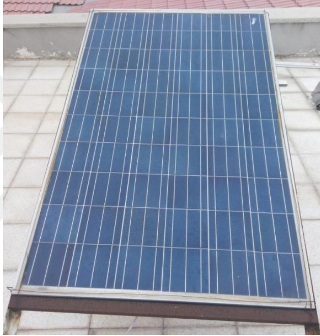
Şekil 2.5 Sistemde kullanılan fotovoltaiik panel
