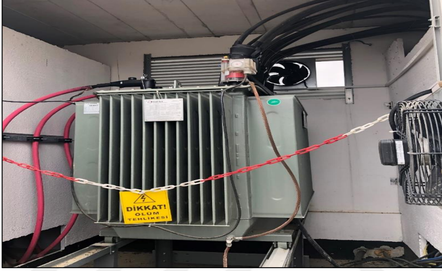
Şekil 56. Santralde kullanılan transformatör örneği
