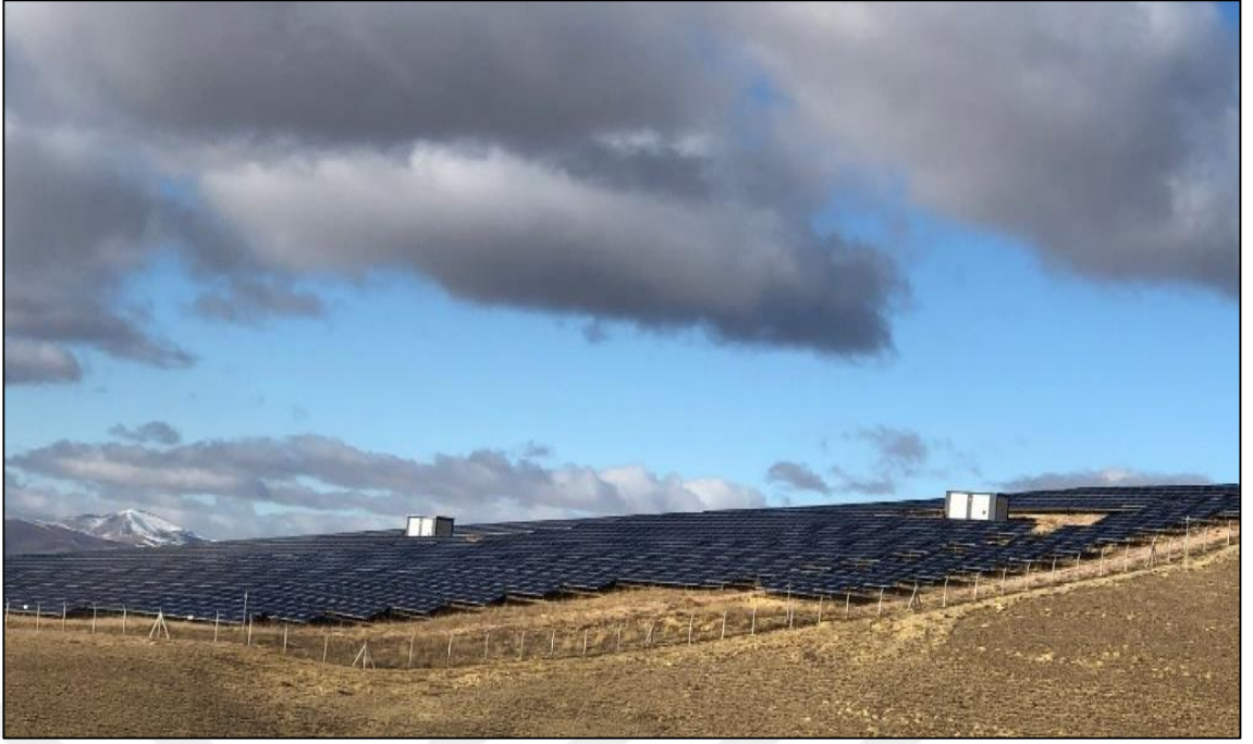
Şekil 52. Güneş enerji santralinin görüntüsü-1
