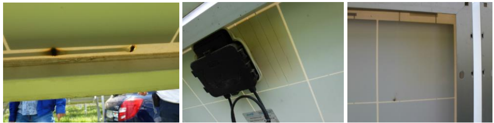
Şekil 4.12. FV hücre üzerindeki mikroçatlakların sebep olduğu ısı arızalar.
