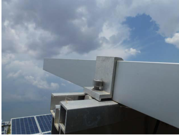
Şekil 4.9. FV modülün taşıyıcı konstrüksiyonuna uygun şekilde bağlanamaması.
